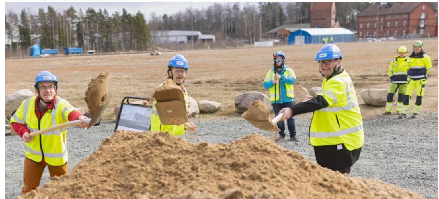
Åhej! Synkade spadtag ur en rejäl jordhög på det blivande tågdepåområdet i Nässjö.
